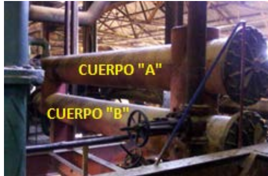
Figura 1. Intercambiador de calor con sus dos cuerpos
