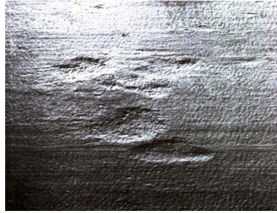
Fig. 4. Oquedades ocasionadas por desprendimiento de cascarilla incrustada, en un producto plano de acero F-154, apreciables después de un chorreado
