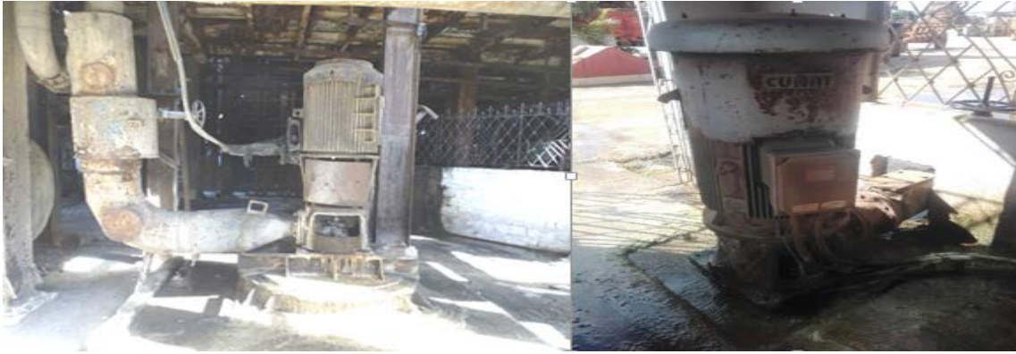
Figura 2. Pozo que abastece de agua al Central Refinería Ecuador (PC1)
